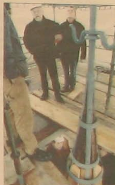
Arkitekt Hans Lund og kirkeværgen Erik Lund Petersen konstaterer, at renoveringen af tårnet skrider planmæssigt frem.
